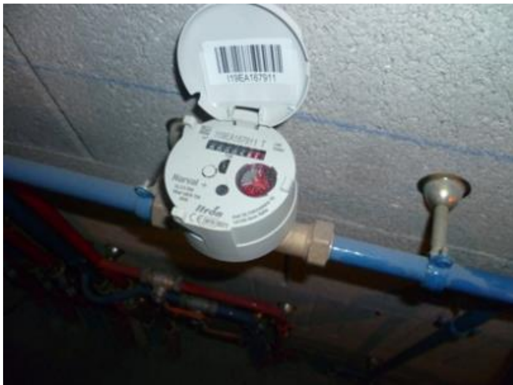
Compteur eau de pluie vers l'assainissement + compteur appoint eau de ville
