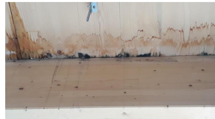
Exemple de bleuissement à la jonction plancher CLT/Poutre suite à une humidité excessive en phase chantier / Codifab
